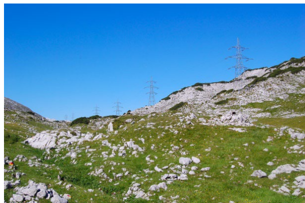
220-kV-Leitung über das Steinerne Meer
